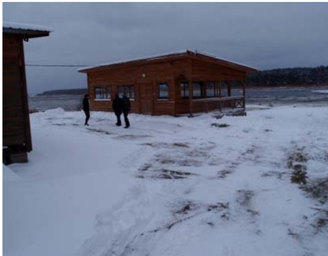
Foto 7. Vaade Kalda tn 32a loodetipus vanale vundamendile ehitatud hooajalisele välikohvikule. K-A. Parksepp 11.11.2016.
